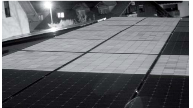
İyi durumdaki güneş panelleri
